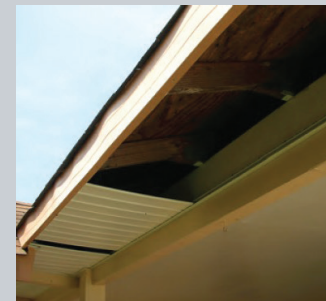
Soffites arrachés par le vent
